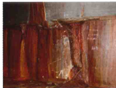
管理用道路トンネル側壁の欠落
