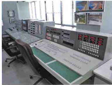
ダム操作盤(ダム管理棟)
