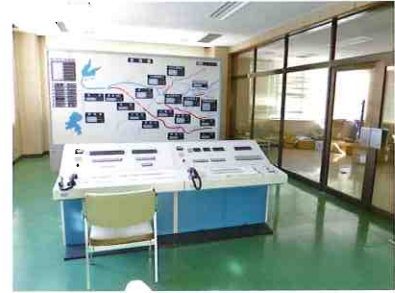
水管理施設(中央管理所)
