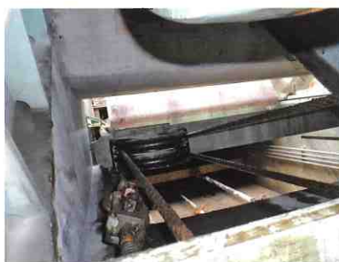
取水ゲートの腐食
