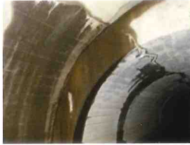
トンネルひび割れからの漏水
