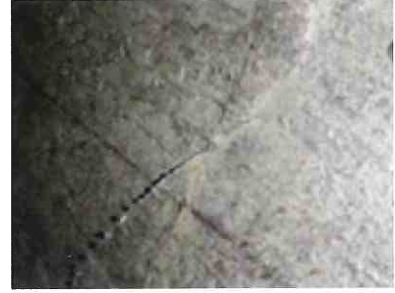
サイホン目地からの漏水
