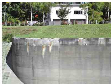
洪水吐の側壁天端が欠損
