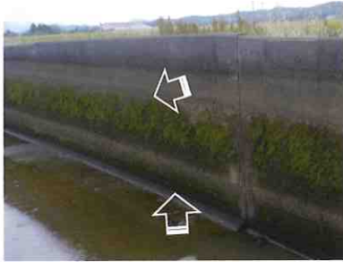
浮上による中江幹線用水路の変状
