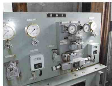
老朽化が著しい操作盤
