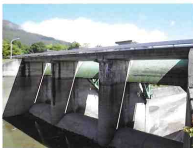
洪水吐堰柱のひび割れ
