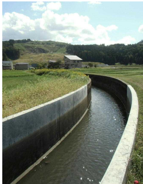
復旧した上江幹線用水路
