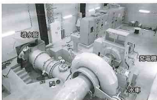
笹ヶ峰ダム小水力発電所 (平成31年7月に発電開始)
