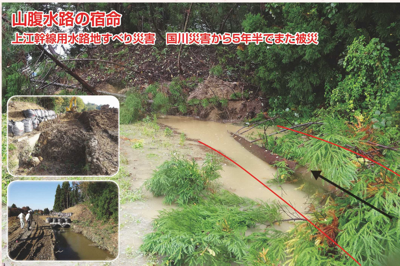
背面▲台風第21号により被災した上江幹線用水路 左上▲応急復旧工事中の上江幹線用水路 左下▲応急復旧工事後の上江幹線用水路
