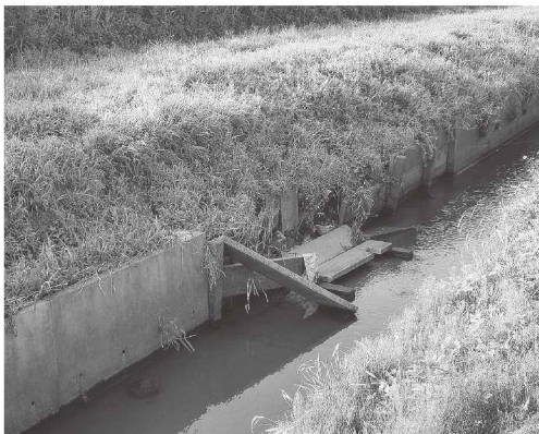
▲重川排水路柵渠倒壊（上越市飯田地内）
