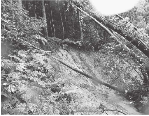
▲上江幹線用水路山側法面崩落（妙高市西条地内）
