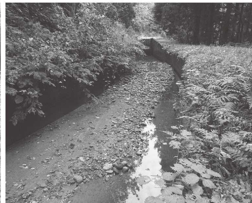
▲上江幹線用水路土砂流入（上越市板倉区山越地内）
