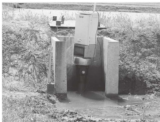
▲多機能型自動給水栓（水まわりくん）
