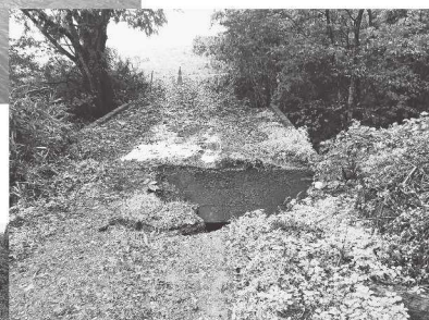
▲藪野農道橋陥没
