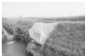
排水路法面で崩落
