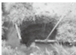
用水路沿いで陥没
