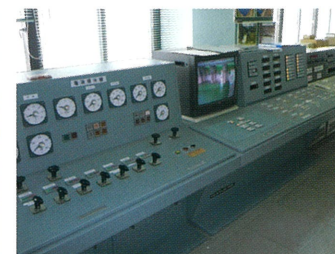
笹ヶ峰ダム監視制御装置
