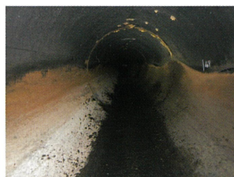
管の腐食（上江幹線用水路三丈堀暗渠）
