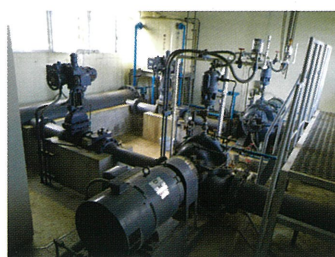
県営ほ場整備 揚水機場（42機場）
