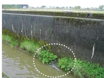
開水路の漏水（中江幹線用水路）
