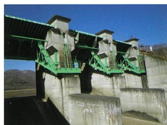
笹ヶ峰ダム洪水吐堰柱のひび割れ
