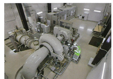
小水力発電所内
