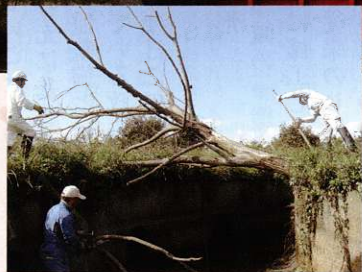
▲矢代川頭首工取入口付近立木伐採 (稲荷中江幹線用水路:上越市今泉地内)
