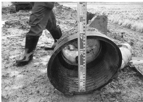
▶変形した排水管（中江北部第2地区・上越市東小猿屋地内）
