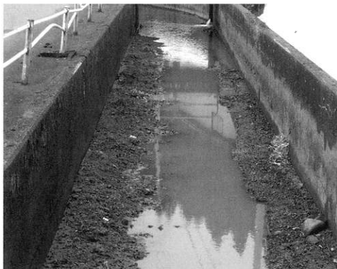
▲堆積した土砂（上江幹線用水路：上越市清里区上田島地内）
