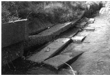
▲柵板が崩壊して危険な重川排水路(上越市飯田地内)
