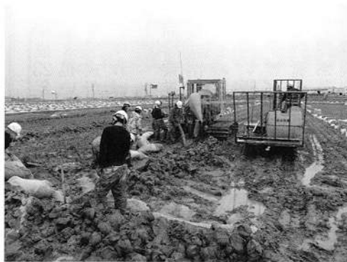
▲暗渠排水工の施工状況(平成23年10月) (中江北部第2地区:上越市四辻町地内)
