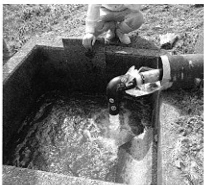
▲ 本事業により改修された用水送水管 (上越市下吉野)
