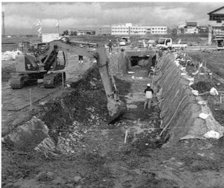
▲上江幹線水路の災害復旧日本工事 (上越市板倉区国川地内)
