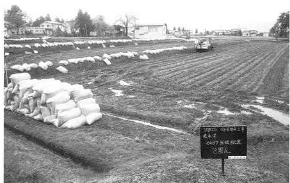
▲暗渠排水 (上越市板倉区沢田)
