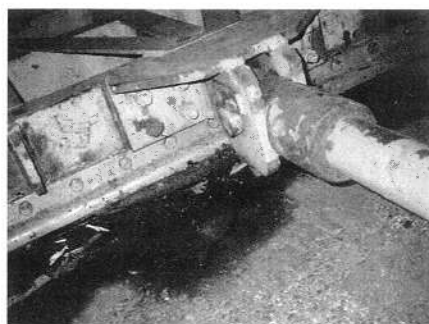
取水ゲートの腐食による劣化
