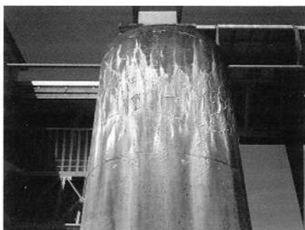
ダム余水吐ゲートのコンクリートひび割れによる老朽化
