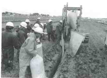
▼県営ほ場整備事業 三和南部地区暗渠排水工事(三和区川浦)
