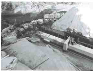
▲台風18号（平成25年9月16日）で被災した滝寺地内の下違池の復旧工事の様子
