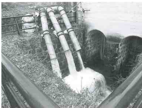
▲3本の鉄管を経由して関川右岸幹線用水路へ放流
