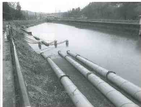
▲板倉調整池にて水中ポンプにより汲み上げ取水 (妙高市巻淵地内)
