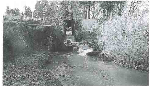
▲融雪水により被災した五野井堰（復旧前）
