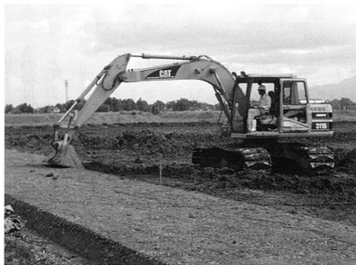
▲急ピッチで進められている工事 (中江北部第2地区：上越市下野田)
